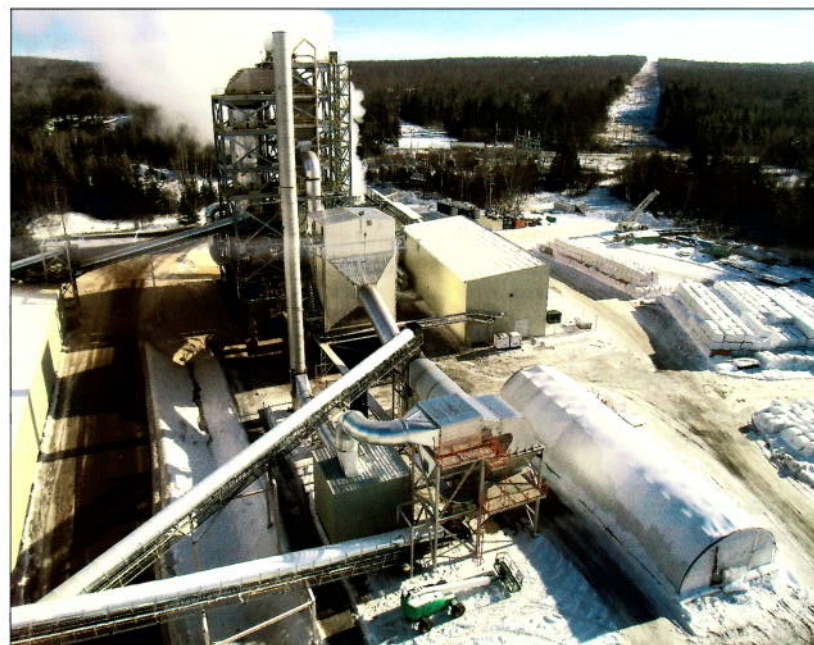
Завод Maine Woods Pellet, оснащенный оборудованием немецкой компании Classen Apparatebau Wiesloch GmbH, выпускает в год свыше 105.000 тонн древесных топливных гранул
