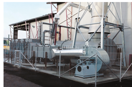
Электрическая беспламенная установка дожиги с технологией «flox» в Финляндии
