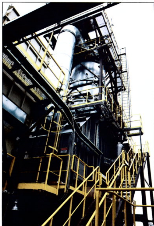
Установка Classen Apparatebau Wiesloch в ОАО «Речицдрев»
