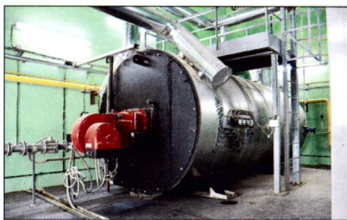
Котел на ОАО «Гомельдрев»
